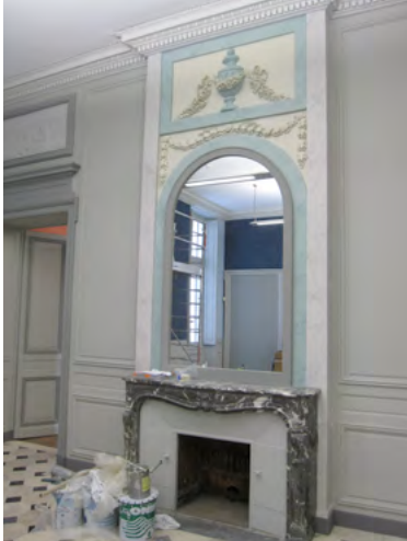
Ancienne salle à manger de l'évêque, détail de la cheminée et de son imposte, en cours de restauration.
