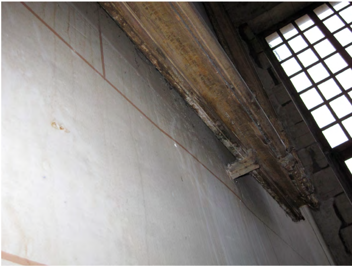
Détail de la traverse basse du cadre avant restauration : traces des effets répétés de l'humidité.
