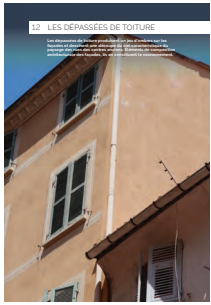
12 les dépassées de toiture
